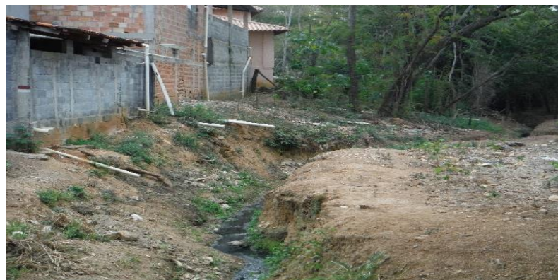
Figura 9.15 – Lançamento de esgotos no corpo receptor.
